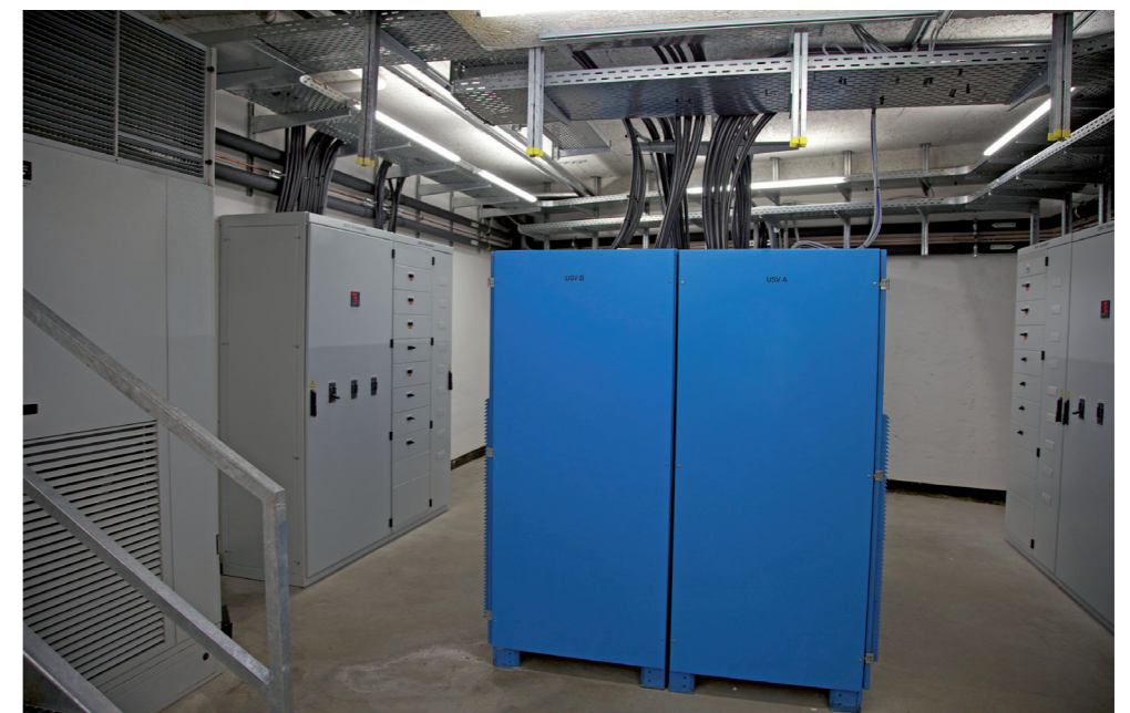
Die USV-Anlage sorgt für unterbrechungsfreien Betrieb im DATASIX Rechenzentrum.
